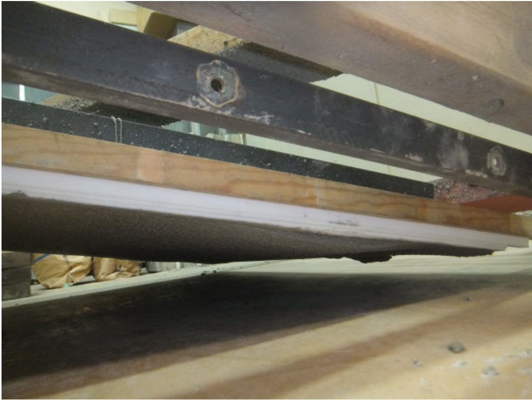
写真 1 1 たるみ状況 (測定部位⑨部)
